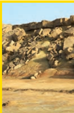
شکل ۱- الف) سنگ در حال تخریب
